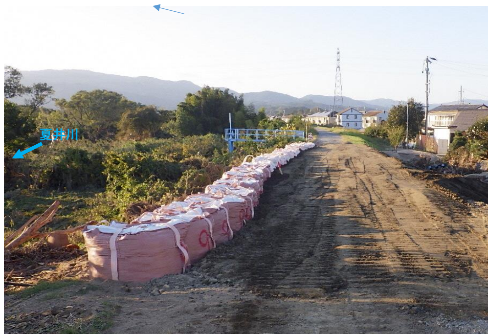
被災状況 (令和元年10月18日撮影)
