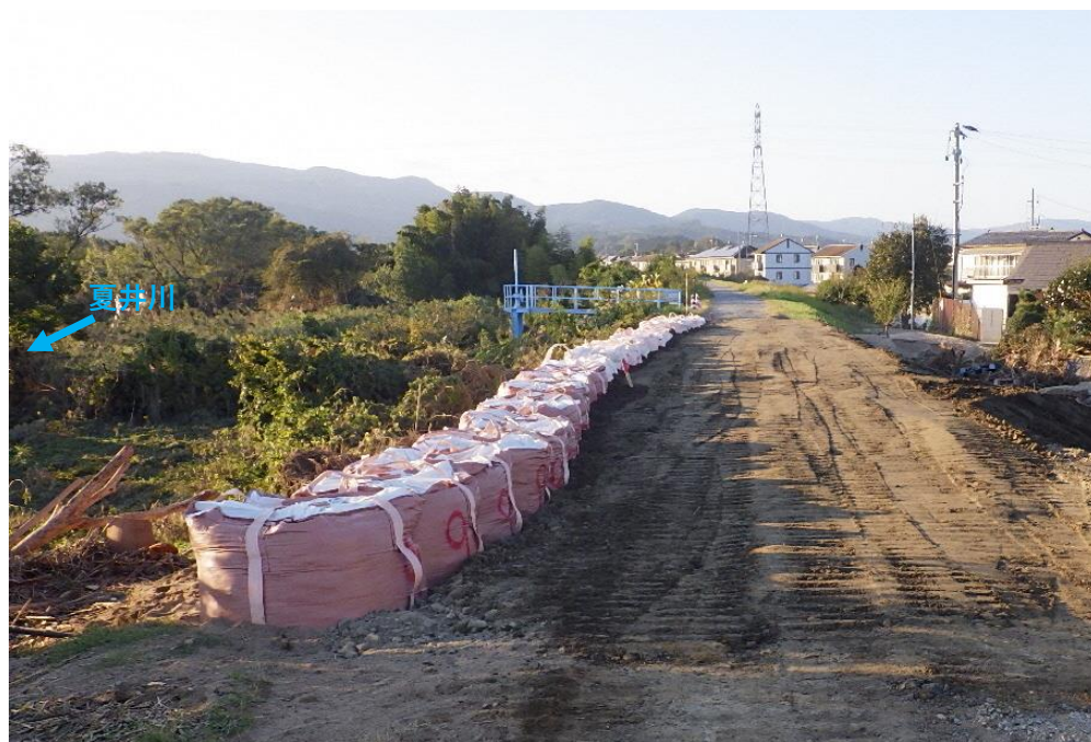
被災状況 (令和元年10月18日撮影)
