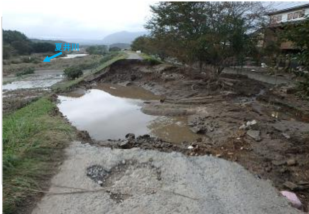
被災状況（令和元年10月13日撮影）
