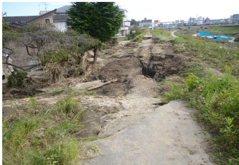
被災状況（令和元年10月14日撮影）
