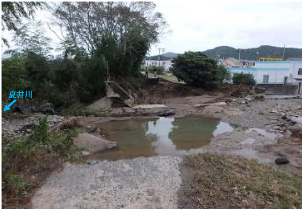
被災状況 (令和元年10月13日撮影)
