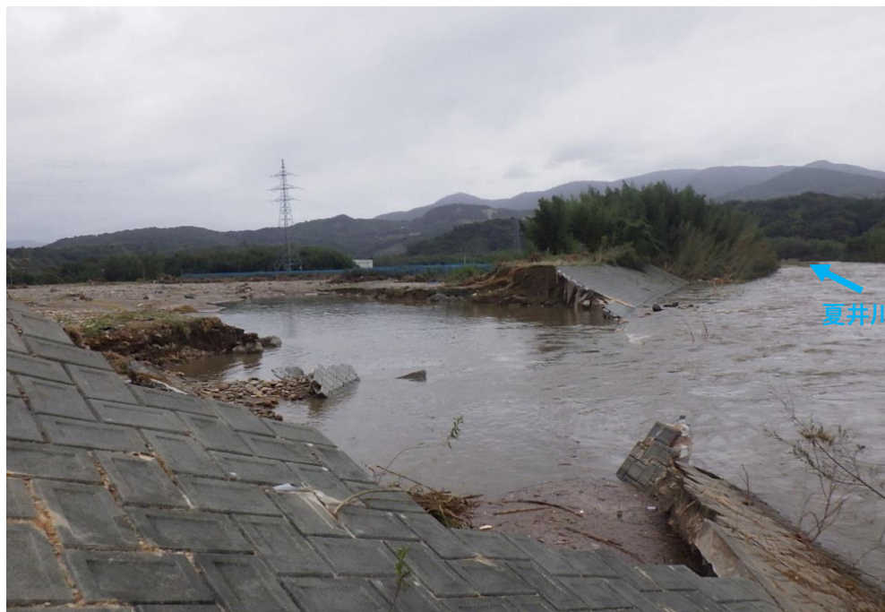
被災状況 (令和元年10月13日撮影)
