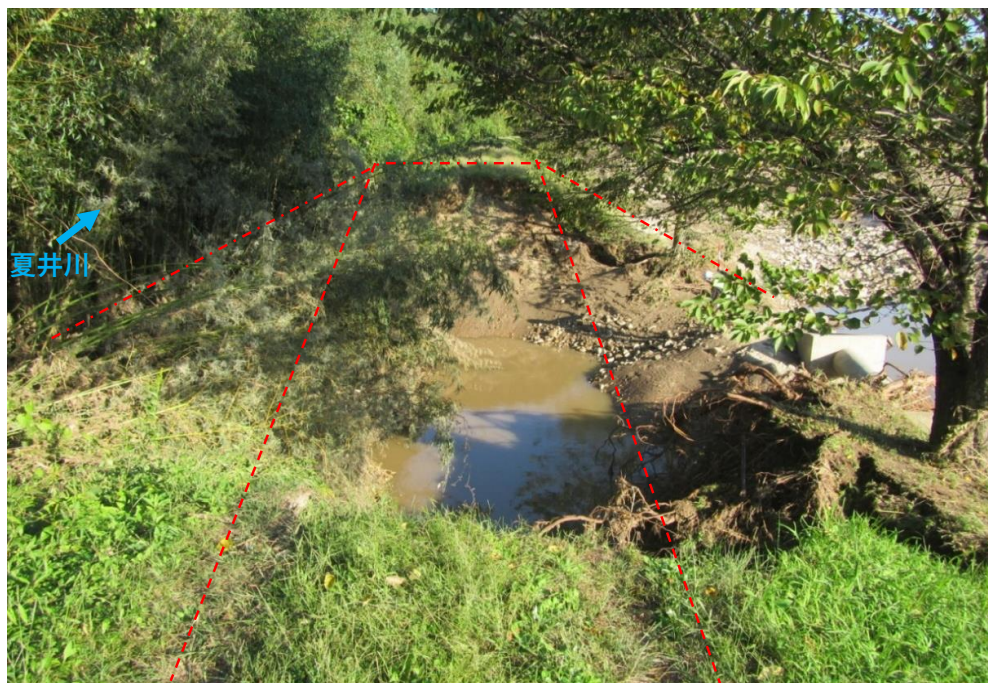
被災状況 (令和元年10月14日撮影)
