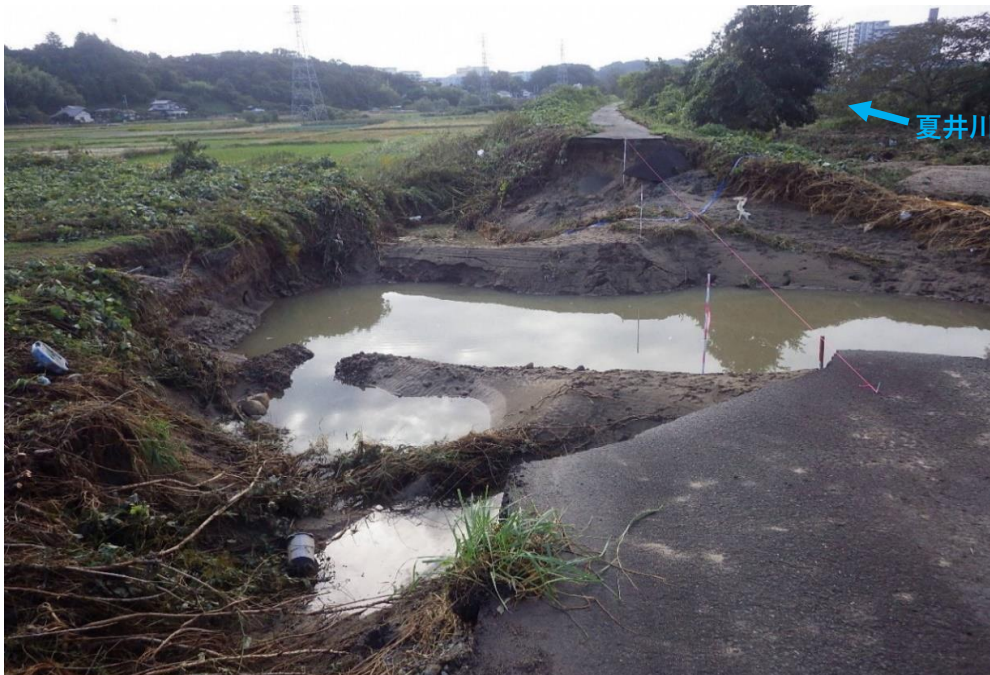
被災状況 (令和元年10月13日撮影)
