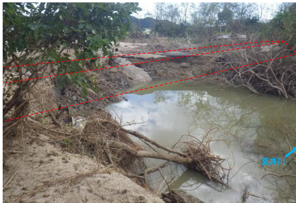
被災状況 (令和元年10月22日撮影)
