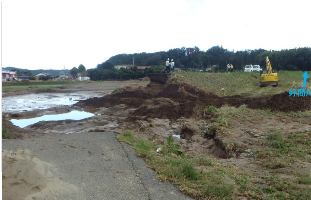
被災状況 (令和元年10月13日撮影)
