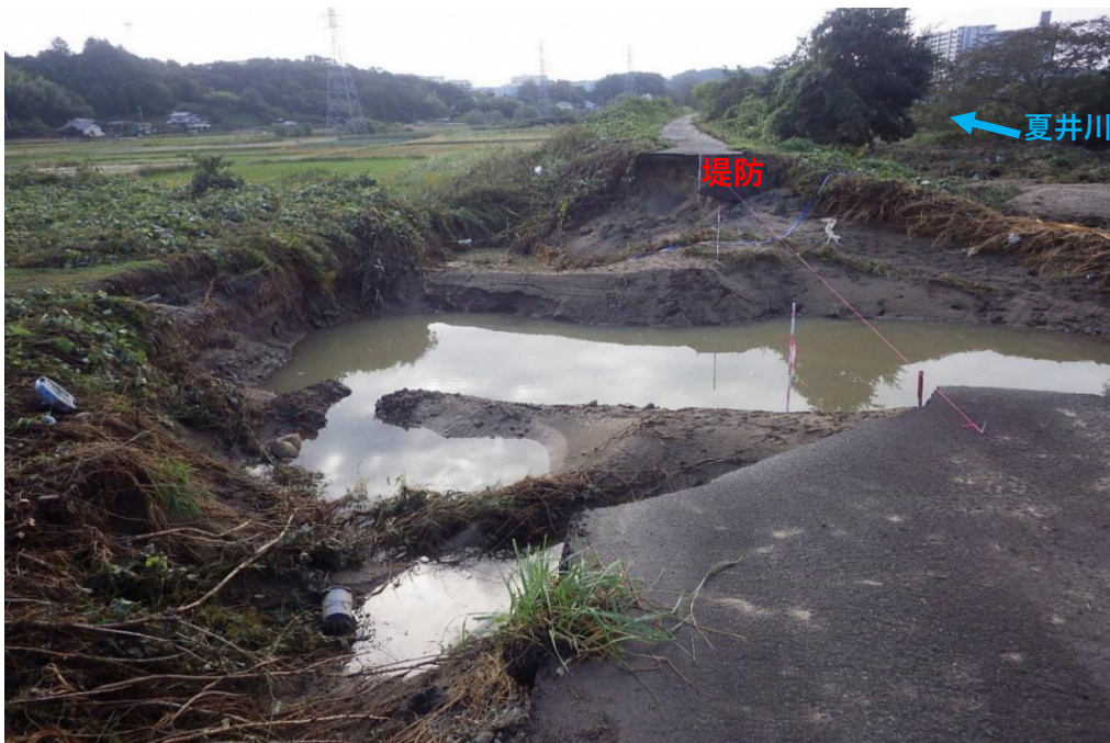
被災状況 (令和元年10月13日撮影)
