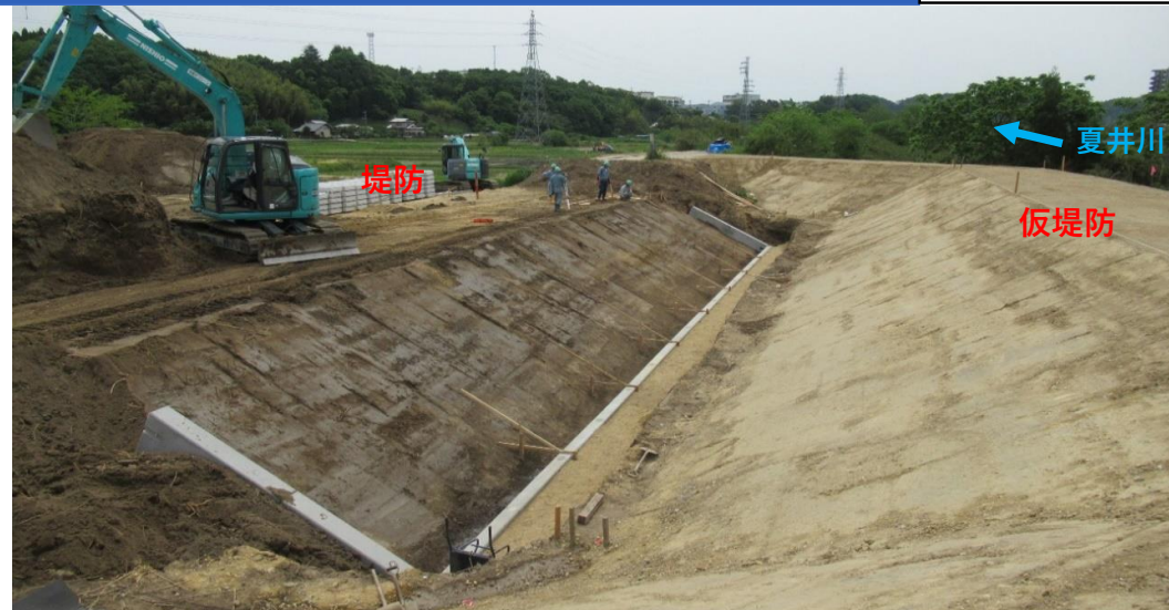
川表側 コンクリート張ブロック着事前 (令和2年5月15日撮影)
