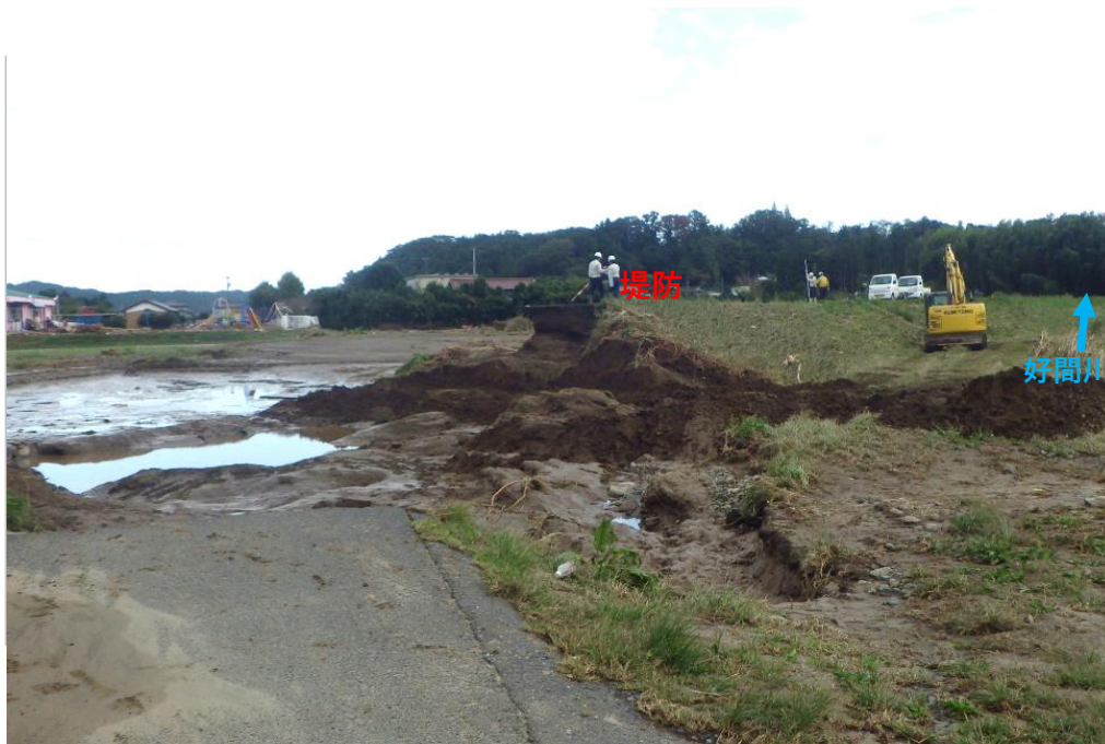
被災状況 (令和元年10月13日撮影)
