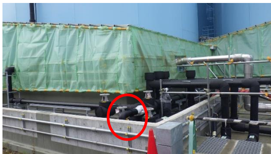
(写真1-1) 追設された配管
