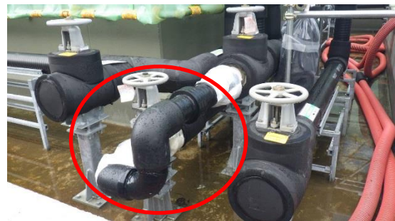
(写真1-2) 追設された配管(拡大)
