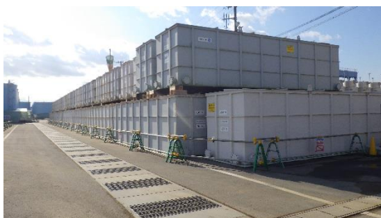
(写真 3 - 3) セシウム吸着塔一時保管施設第一施設 西側
