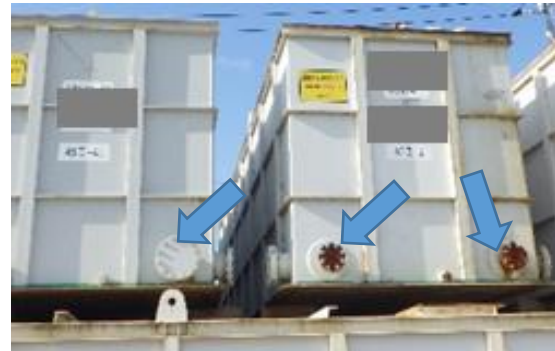
(写真4-2) セシウム吸着塔一時保管施設第一施設西側
