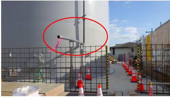
(写真2) (写真1)の下部を拡大。赤丸が雨水排水管。
