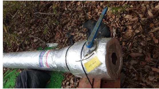
(写真 2 - 2) (写真 2 - 1) の弁の部分 を拡大
