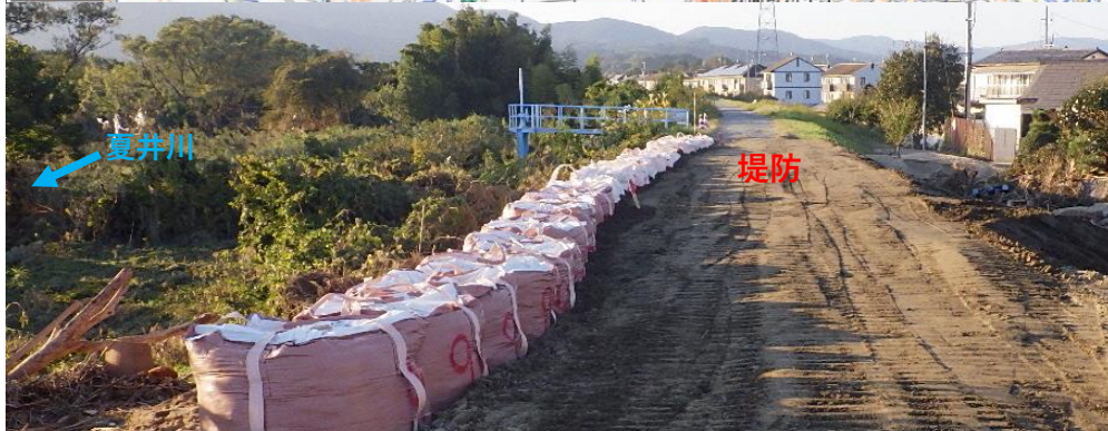
被災状況 (応急仮工事後)
