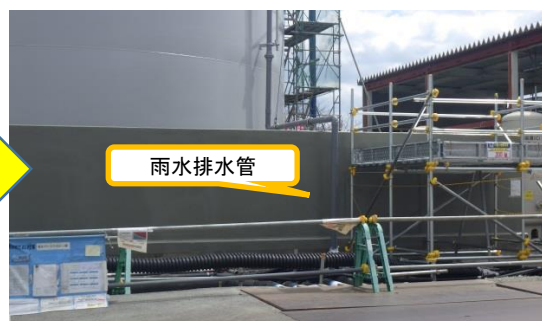
(写真2-2) 完成した雨水排水管。タンク天板に降った雨水は堰外へ排水される。 今回撮影 (平成31年4月4日)
