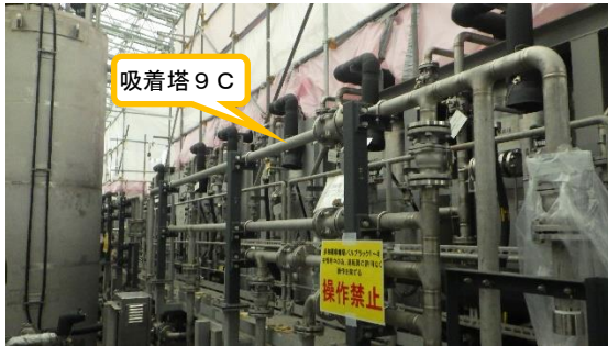
(写真1-1) 既設多核種除去設備 (C) 吸着塔9C付近の状況①
