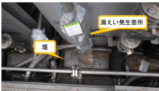
(写真1-2) 漏えい発生箇所の状況
