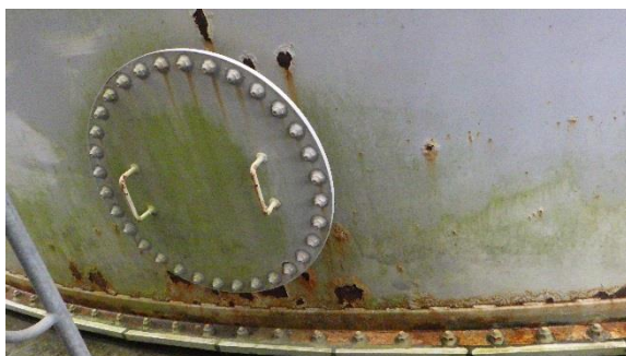
(写真 4) タンク側板及び底部の表面の状況 (A 2 タンクの例)
