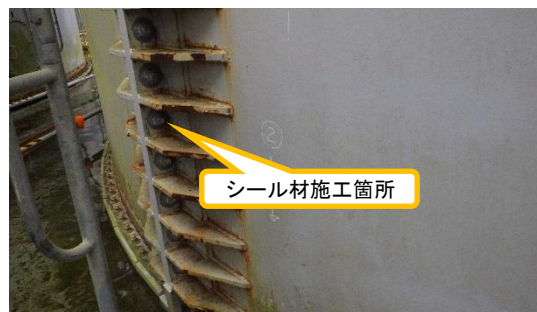
(写真 3 - 3) 第一段側板フランジのシール材施工の状況③ (B1タンク 側部接合部の例)
