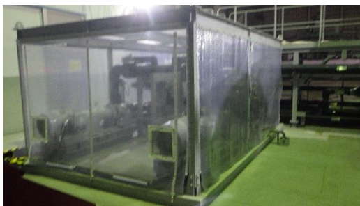
(写真1-2) ブースターポンプ(カバーの奥に2基設置されている)
