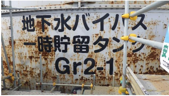
(写真4) タンク側板表面の状況 (Gr2-1タンクの例)
