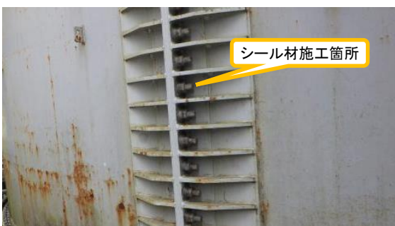
(写真3-3) 第一段側板フランジのシール材の施工状況③（側部接合部の一例）
