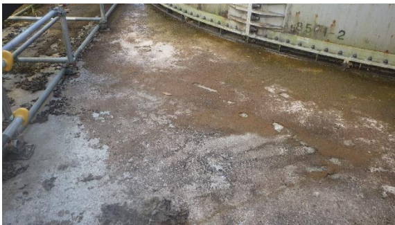
(写真4-2) 堰内の土砂等堆積状況の例①
