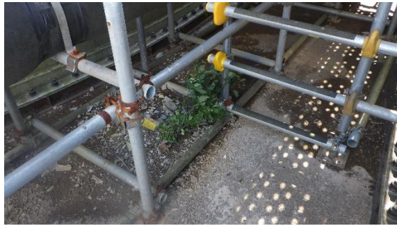
(写真4-3) 堰内の土砂等堆積状況の例②
