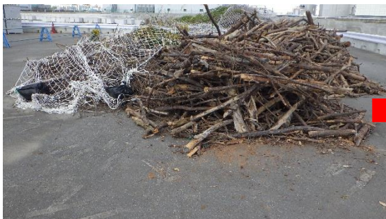
(写真1-1) 対策前の状況 前回 (令和元年11月8日撮影)
