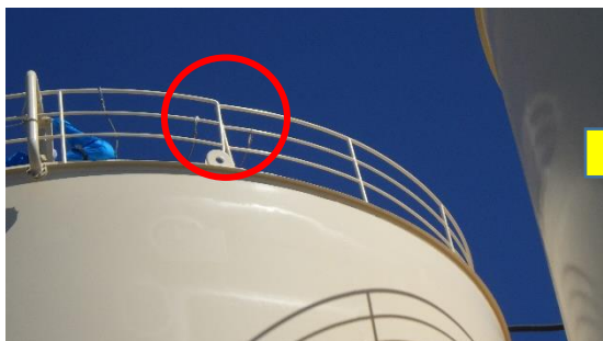
(写真5-1) 天板手摺りの歪み (令和元年10月9日撮影)
