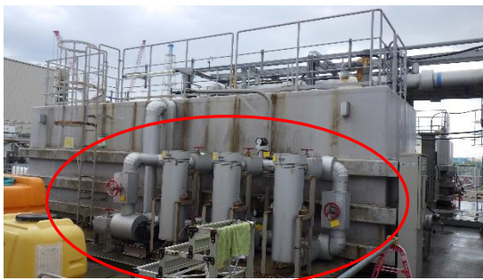
(写真1-2) (写真1-1)の浄化装置を別方向から撮影し、拡大
