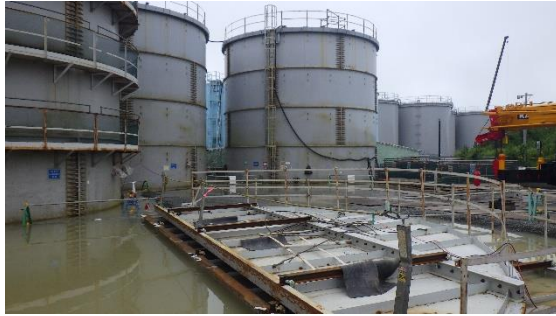
(写真 2) 堰内の雨水の状況
