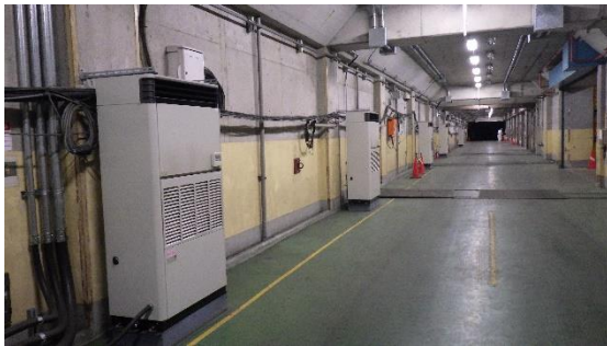
(写真6) 地下2階にはエアコンが設置され、 稼働していた。
