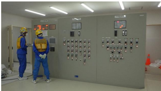
(写真 2 - 9) 制御室内部の状況（監視盤付近） 試運転が実施されていた
