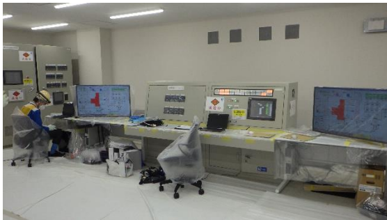
(写真 2 - 8) 制御室内部の状況（監視モニタ付 近） 試運転が実施されていた
