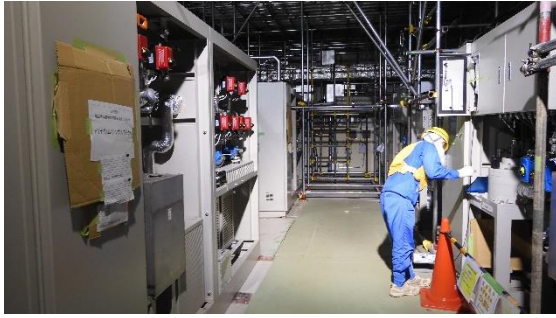
(写真 2 - 7) 排ガスモニタ室の状況 試運転が実施されていた
