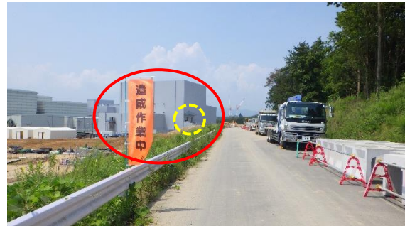
(写真1-2) 今回撮影(北東側から撮影) 赤丸部分が増設雑固体廃棄物焼却設備建屋 黄色点線丸部分はトラックによる廃棄物搬入口
