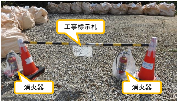
(写真2) 工事標示札及び消火器の設置状況
