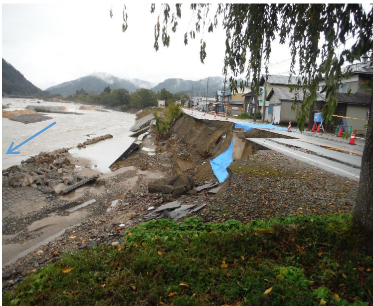
被災状況（令和元年10月15日撮影）
