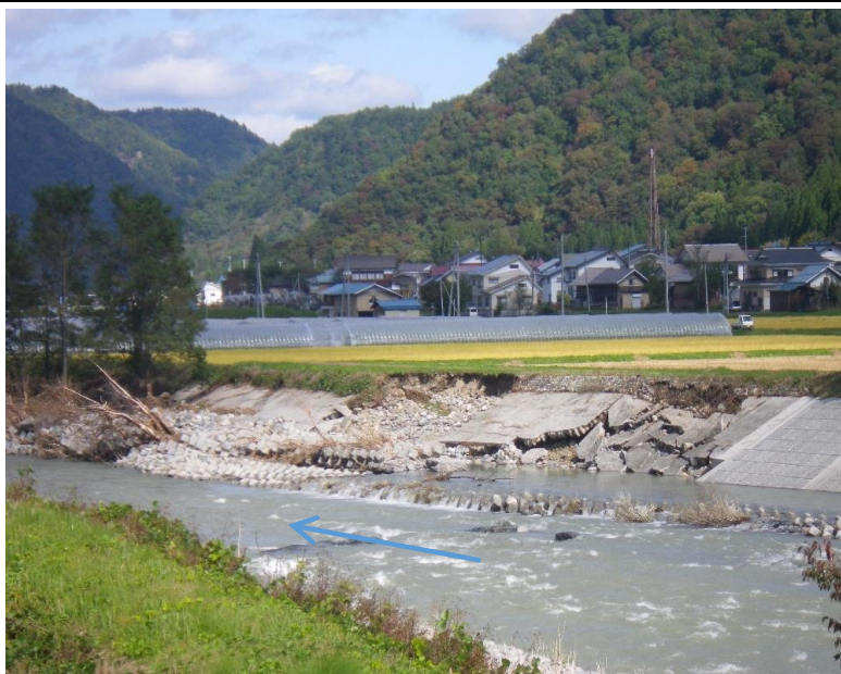
被災状況（令和元年10月15日撮影）
