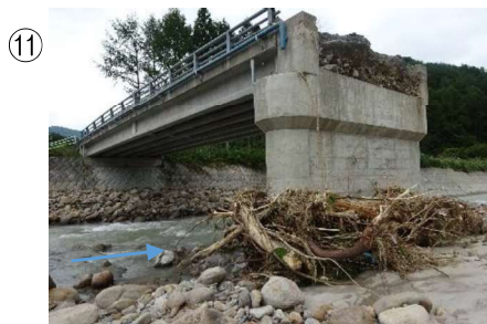
⑪ 静川地内 出合橋が落橋
