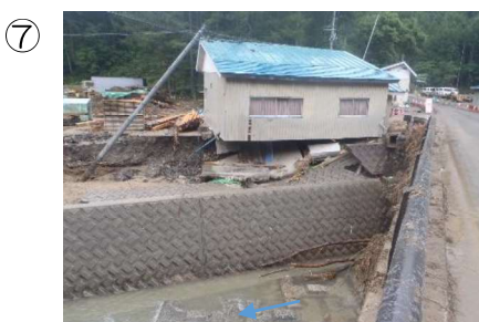
⑦ 建物の基礎部が浸食される
