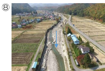
⑧ 静川地内 高橋下流の護岸の侵食状況（ドローン撮影）
