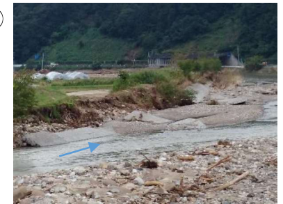
伊予戸地内の護岸流出状況
