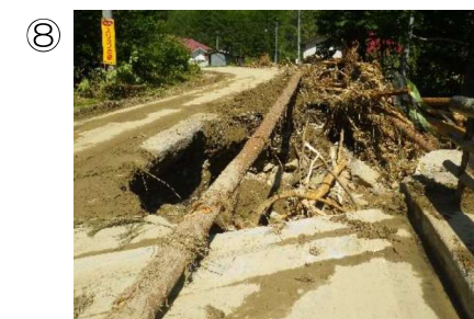
⑧ 新田橋橋台背後の洗掘状況
