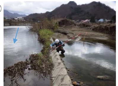
越水により護岸の裏側が流出した
