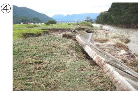
④ 福米沢地内 越水による破堤及び背後地への浸水痕跡
