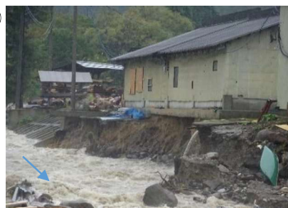
⑱ 針生地内 木材工場の基礎部が浸食される
