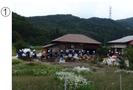
① 塩江地内 桧沢川からの越水による家屋への土砂流入状況
