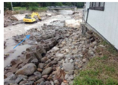
⑫ 静川地内 家屋の基礎部が浸食される
