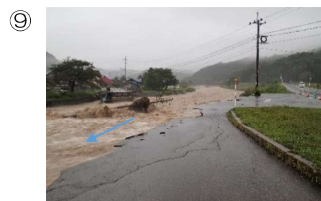
⑨ 静川地内 高橋に流木が引っ掛かり落橋
