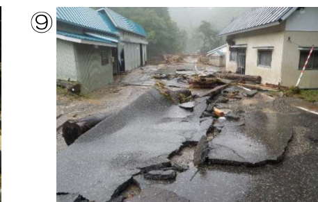
⑨ 越水した水がアスファルト舗装の下を流れたことによる路面状況
