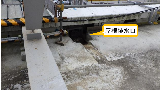
(写真3-1) 3号機タービン建屋低層部屋上に設置されている屋根排水口
