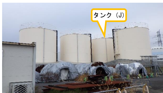
(写真4) サブドレン一時貯水タンクエリアの 外観（南東側から撮影）
