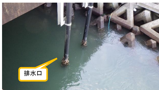
(写真6) サブドレン処理水排水口の状況 （異常は確認されなかった。）
