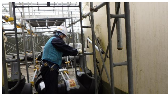
(写真5) タンク（J）の排水ライン弁開放状況
