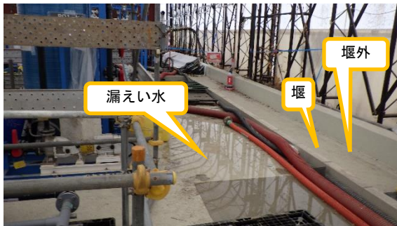
(写真 2 - 3) 堰内の漏えい水滞留の状況 (堰外に水の流出の形跡はない。)
