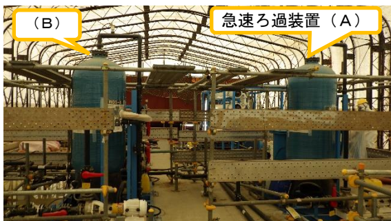
(写真2-1) 淡水化装置の急速ろ過装置 (A)、 (B) の状況
