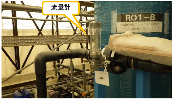
(写真 2 - 2) 損傷した流量計の状況
