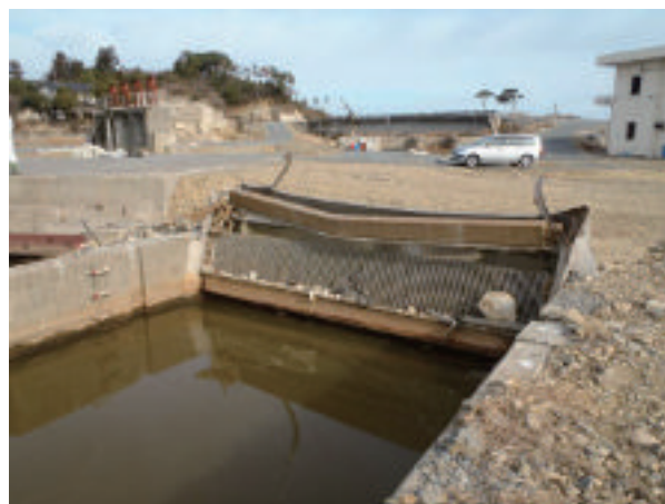
写真-6 除塵機流出状況(小高地区)
