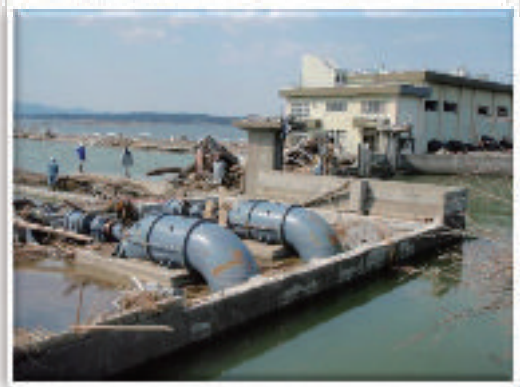
八沢(奥)及び八沢浦(手前)排水機場(南相馬市)
