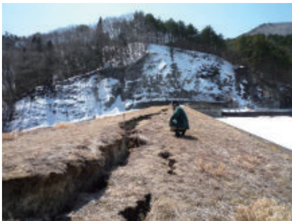
図-1 三ツ森ため池の被害状況
