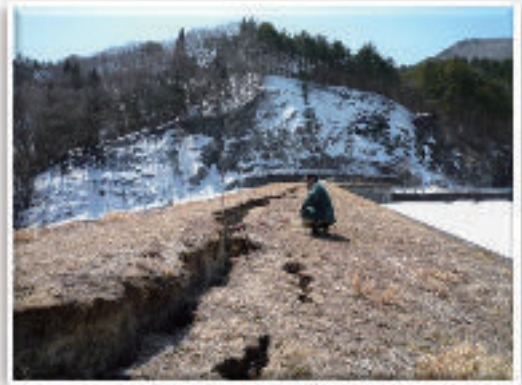
堤体の亀裂（三ツ森ため池）大玉村
