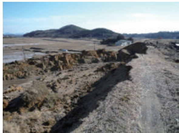
図-2 青田新池の被害状況
