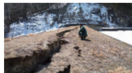
写真-2 大規模なクラックが入ったため池(満水状態) ⇒まだ防災可能 ⇒最優先に対応
