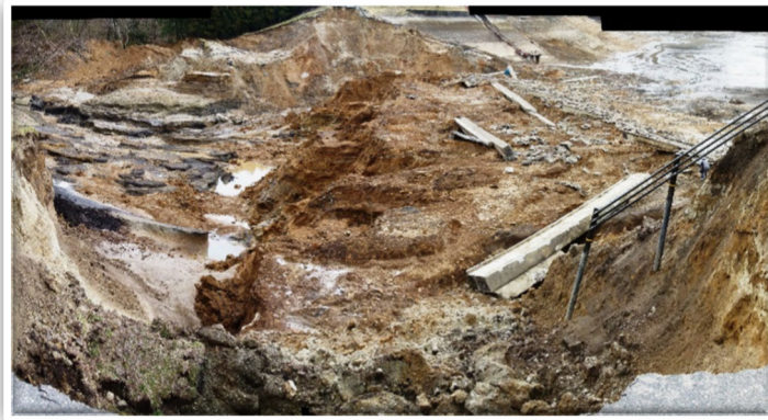
破堤後の本堤
