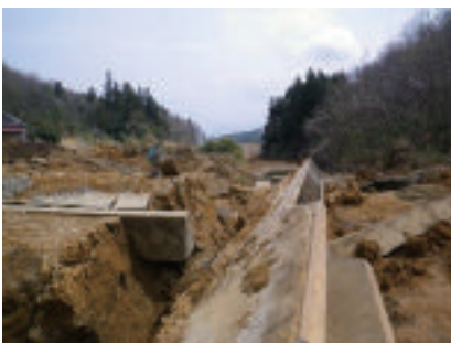
写真-1 決壊したため池(須賀川市)
