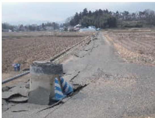
写真-1 管路の被災状況
