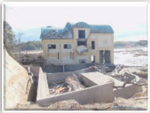
古磯部排水機場(相馬市)
