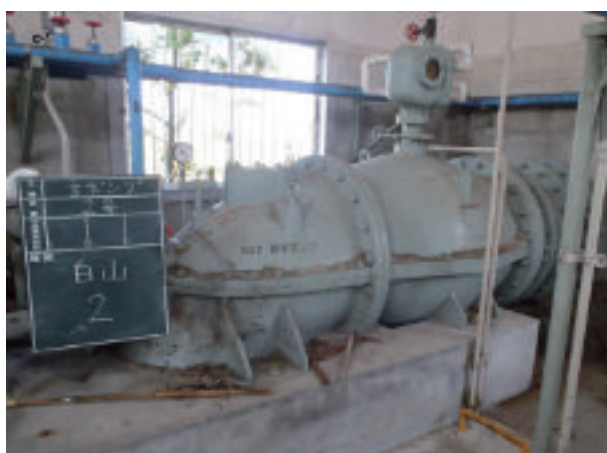
写真-5 ポンプ設備の被災状況写真(白山地区)
