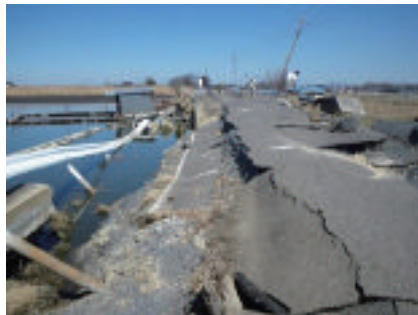
写真-2 沈下、崩落したため池(鏡石町)
