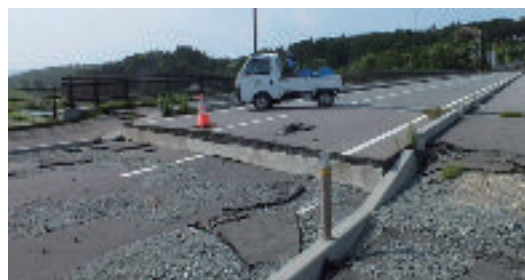
写真-4 地震により通行できなくなった橋梁
