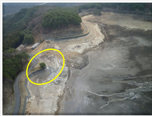
副堤(黄色丸枠内)のすべり
