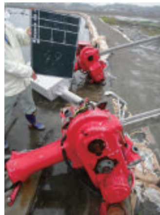
写真-2 樋門ゲート(開閉装置)の被災写真(新田地区)
