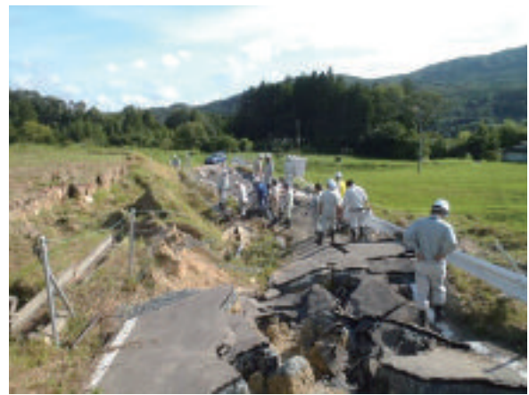
写真-2 査定状況(いわき管内の道路)
