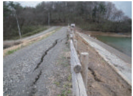
写真-3 堤頂の亀裂(須賀川市)
