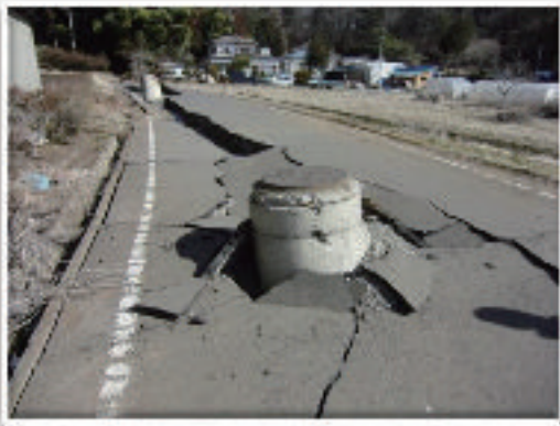
集落排水施設マンホールの隆起 (泉崎村柵内)
