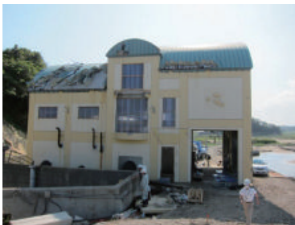
写真-3 建屋の被害状況の写真(古磯部第二地区)
