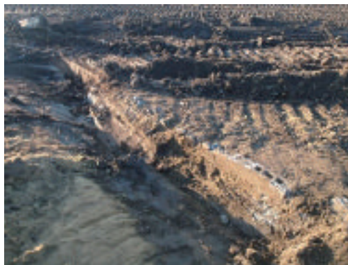
写真-2 宅地跡残留物(ブロック塀基礎)
