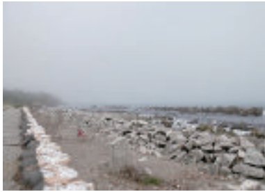
写真-1 浅見川地区被災状況
