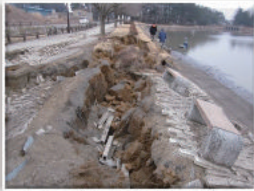
池敷のすべり（大池）矢吹町
