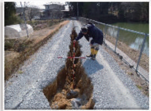
堤体の亀裂（押手神ため池）新地町
