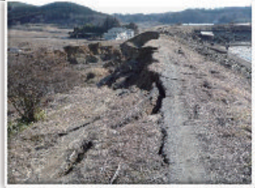
堤体の崩壊（青田新池）本宮市
