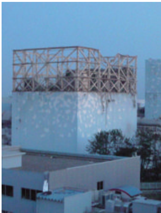
写真-1 事故後の福島第一原発1号機 (平成23年3月12日撮影)
