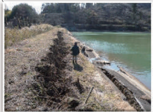
波除工の崩壊（岩根大池）本宮市
