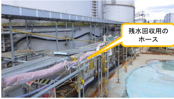
(写真2) 残水回収用のホース 耐圧ホースの上にさらにカバーを 被せて二重化されていた。
