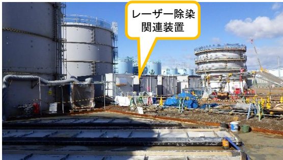
(写真3) レーザー除染関連装置等の状況 (東側から撮影)
