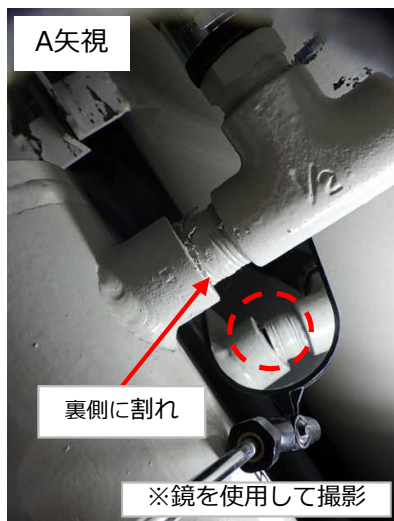
①損傷箇所（継手の付け根が割れ）
