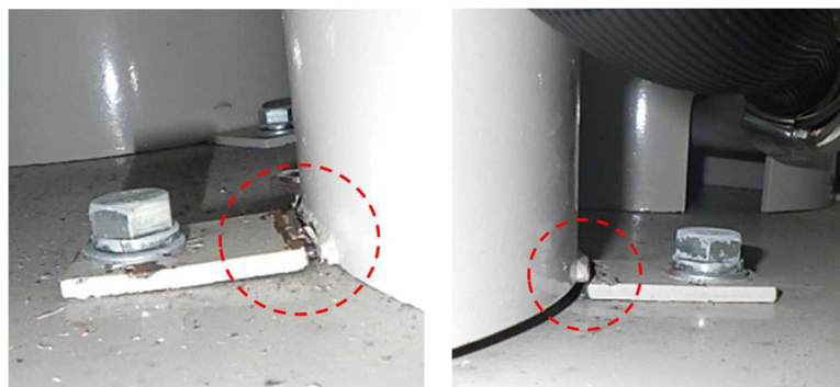
②損傷箇所（固定部割れ）
