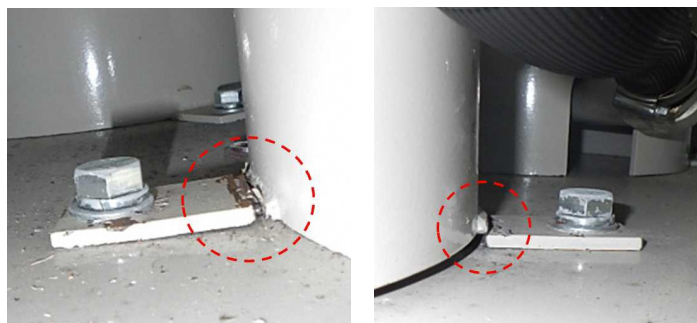
② 損傷箇所（固定部割れ）
