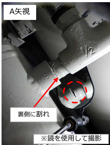
① 損傷箇所（継手の付け根が割れ）
