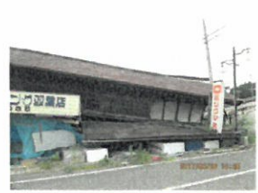
1階部分が潰れた建物 (6年後の街)
