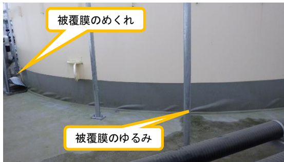
(写真 2 - 1) N 1 タンクの滑動の状況① 西側から撮影
