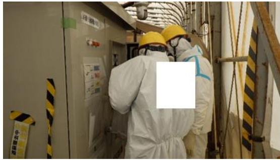
(写真1-3) 制御盤を確認中の東京電力社員及び作業員
