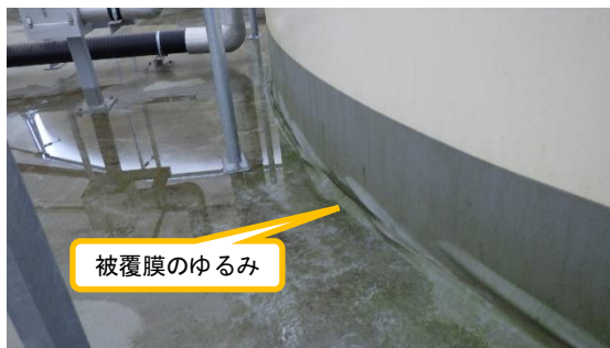
(写真 2 - 2) N 1 タンクの滑動の状況② 東側から撮影
