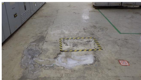
(写真2-2) 電気品室床面の湧水の状況 (今回撮影：令和3年4月19日)
