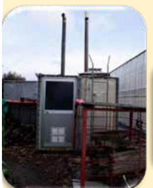
廃材再利用によるボイラー室
