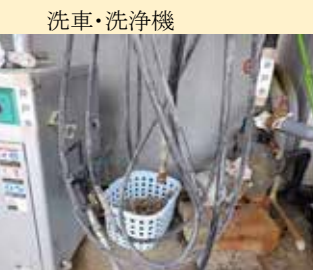
洗車・洗浄には地下水を利用(揚水設備)
