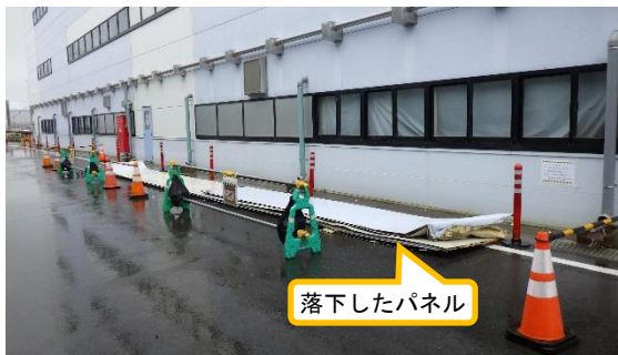
(写真4-1) 大型機器メンテナンス建屋（北側） 周囲の状況 (今回撮影：令和3年2月15日)
