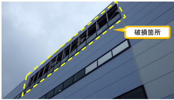
(写真3-1) 大型機器メンテナンス建屋北側壁面 パネルの破損箇所 (前回撮影：令和3年2月15日)
