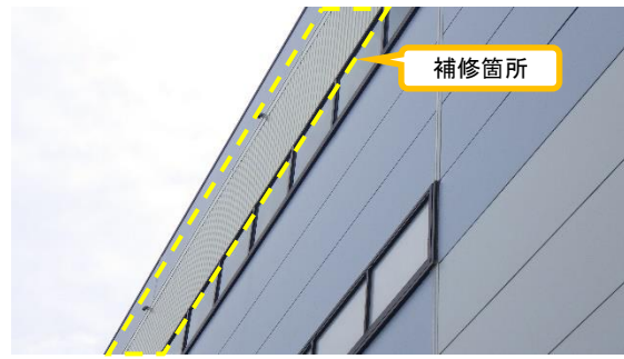
(写真3-2) 大型機器メンテナンス建屋北側壁面 パネルの補修箇所 (今回撮影：令和3年5月10日)
