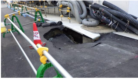
(写真1-1) サイトバンカ建屋北西側陥没箇所 (前回撮影：令和3年3月24日)
