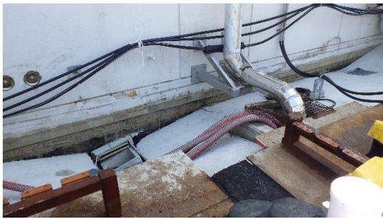
(写真2-1) サイトバンカ建屋西側陥没箇所 (前回撮影：令和3年3月24日)
