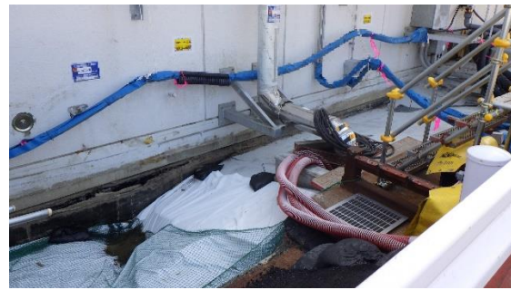
(写真2-2) サイトバンカ建屋西側陥没箇所 (地盤陥没が進行している箇所) (今回撮影：令和3年5月10日)
