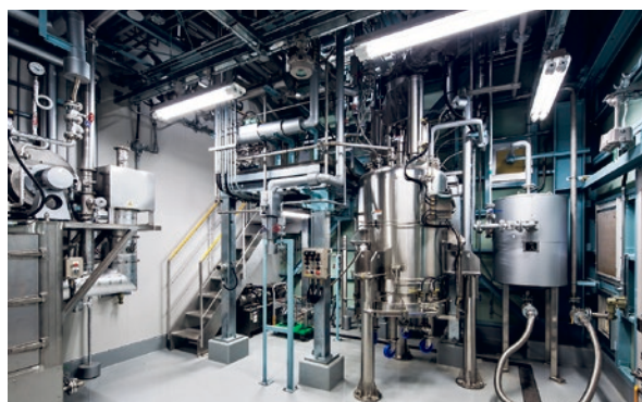
プロセス実験棟内設備
