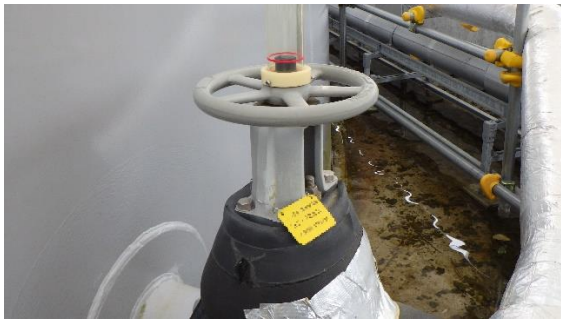
(写真 2 - 2) J 3 雨水回収タンクの払出弁 (払出弁は「全閉」)
