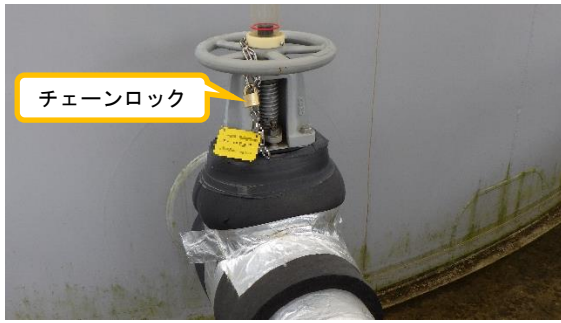
(写真 2 - 1) J 2 雨水回収タンクの払出弁 (払出弁は「全閉」)
