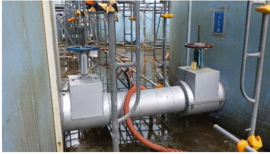
(写真 2 - 1) H 8 北タンクエリアの連結管の例
