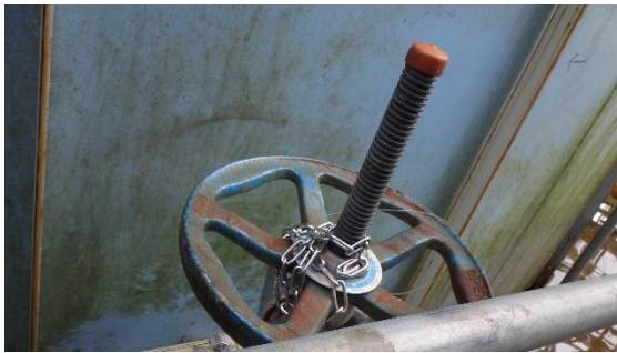
(写真 2 - 2) 弁ハンドルのチェーンロックの状況
