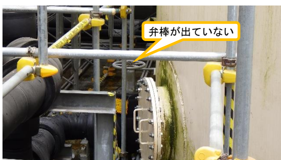
(写真4-2) サブドレン一時貯水タンク (H) 以外のタンクの排水弁の状況の一例 (タンク (A) 「全閉」)
