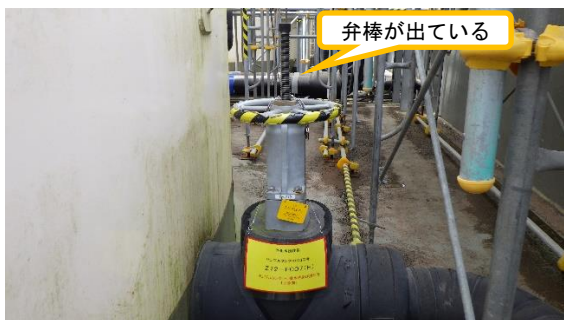
(写真4-1) サブドレン一時貯水タンク (H) の 排水弁の状況 (「全開」)
