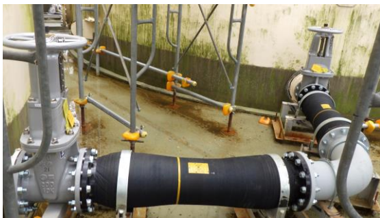
(写真2-1) K1南タンクエリア 新品に交換された連結管・連結弁
