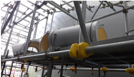
(写真3-3) K2タンクエリア 取り外されている保温材 新品に交換された連結管・連結弁付 近に仮置きされていた
