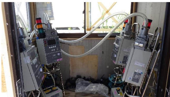
(写真2) 設置作業中の連続ダストモニタ
