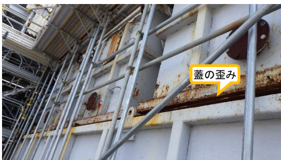
(写真3) 劣化したノッチタンクの一例
