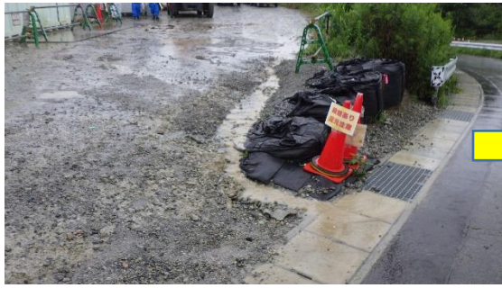
(写真3-1) 一時保管エリアP南側排水溝の状況 (前回：7月7日撮影)
