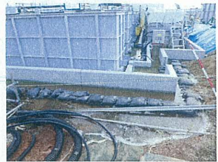
漏えいの状況（①エリア）
