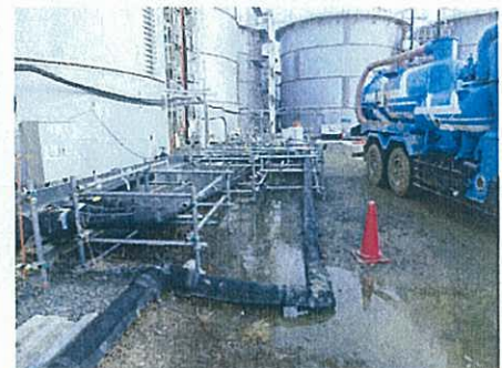
漏えいの状況（③エリア）
