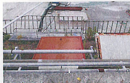
3号機 海側立坑閉塞状況
