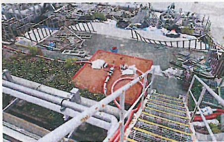
2号機 海側立坑閉塞状況
