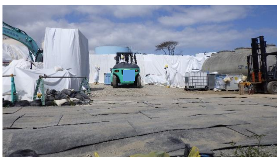
(写真1) 一時保管エリアP2入口付近における作業の状況（南側から撮影）
