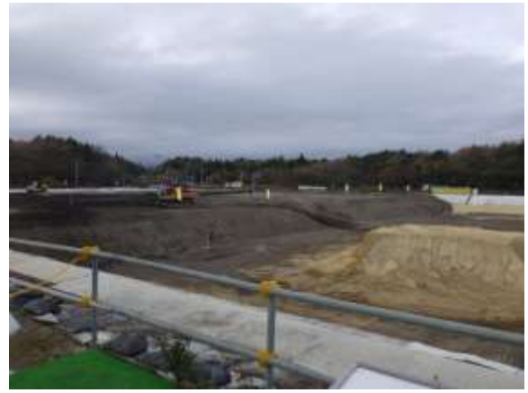
土壌貯蔵施設での埋立状況 重機による転圧が行われ、飛散防止対策が図られていた。
