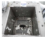
今回損傷が確認された フィルタ
